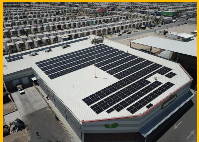
Merco Pilares. (Energía Real)
